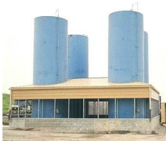
Ilustración 7 - Tanques verticales y su pileta de contención techada
